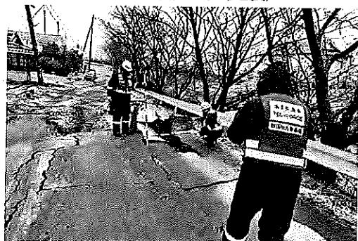
写真2 被災状況調査 (令和6年能登半島地震)
