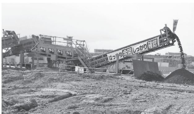
図-3 設備の全景
