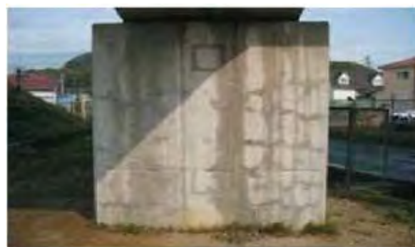
< ひび割れ発生例 >
